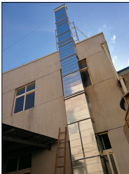
焊接烟尘排气筒
