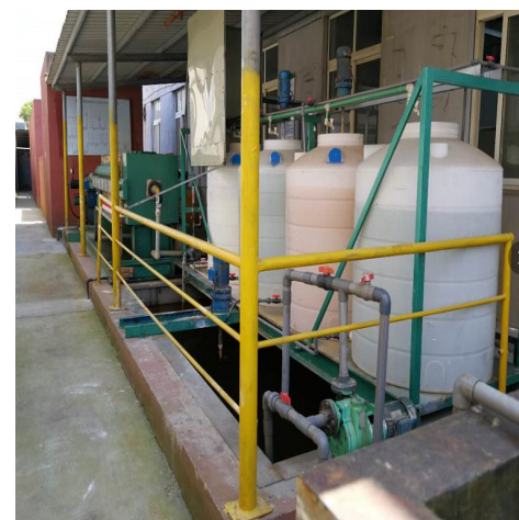
废水处理设施
