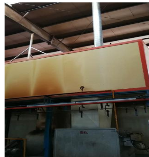
天然气燃烧器及排气筒
