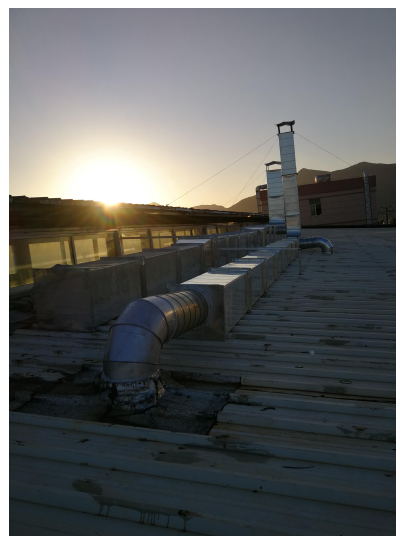
电泳废气排气筒
